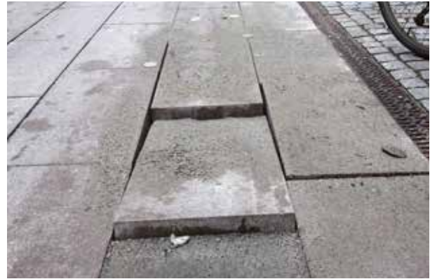
Fig 4.46 Stenmjöl har använts för fog och sättningslager. Den stora andelen finmaterial gör att vatten blir stående i fog och sättningslager. Vibrationer från biltrafiken pumpar bort finandelen ur fog och delvis ur sättningslagret och plattorna lossnar.
