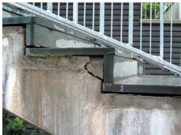
Fig 7.34 Frost- och saltsprängning av läggbruket i trappa med plan- och sättsteg.
