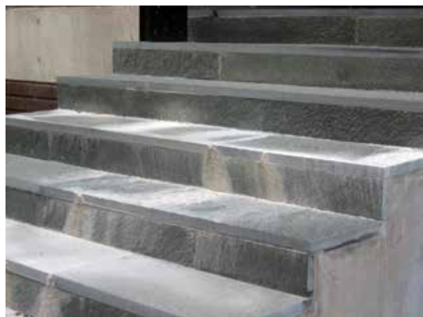
Fig 7.33 Misspyrdande salt- och kalkutfällningar, som är svåra att avlägsna. Sådana bildas när stora mängder vatten transporteras genom cementbruk.
